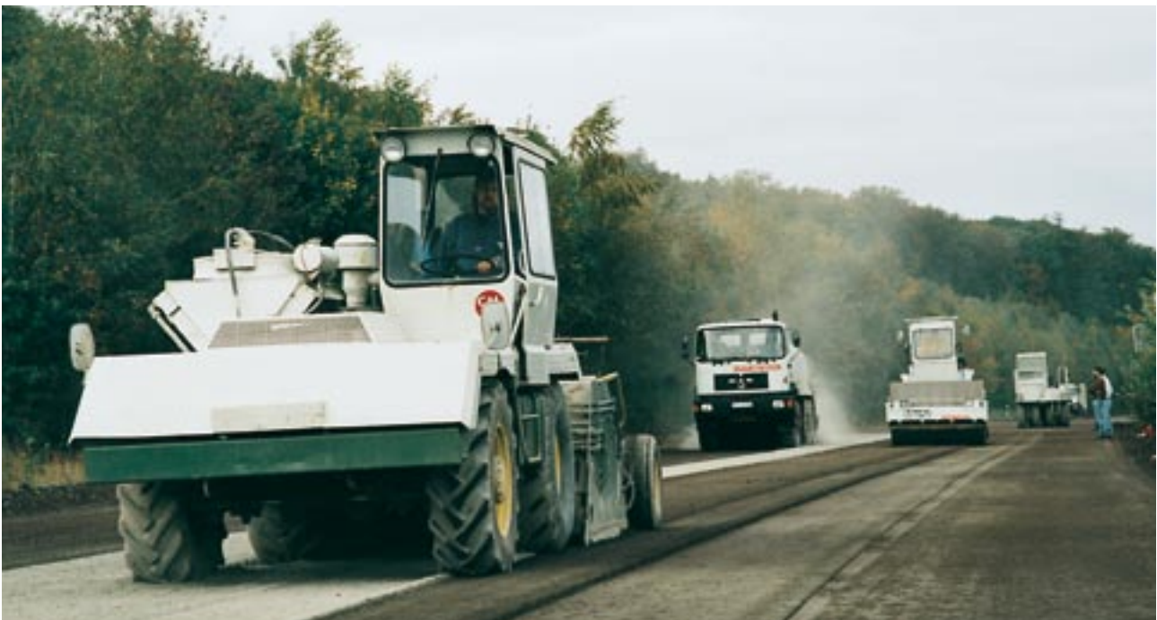
Bild 1: Verfestigung im Baumischverfahren – leistungsfähige Geräte garantieren eine rasche und zuverlässige Ausführung des Bindemittel-Aufstreuens, -Mischens und -Verdichtens
